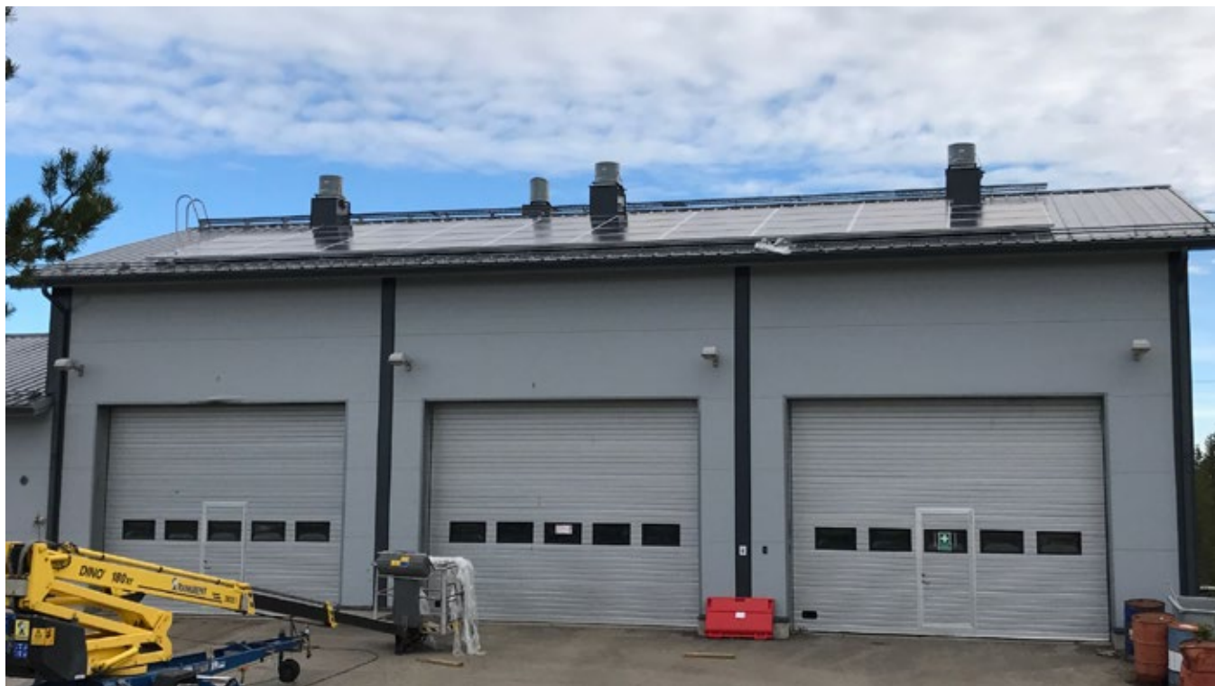
Kuusiselän kaatopaikalla panostetaan uusiutuvaan energiaan. Huoltohallin katolle asennetut 38 aurinkopaneelia lisäävät alueen energiaomavaraisuutta.
